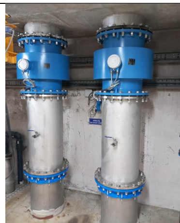
Fig.4c : Renouvellement des débitmètres entrée station Goilard
